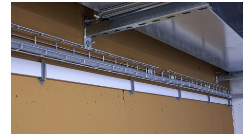
An der Wand installiert
