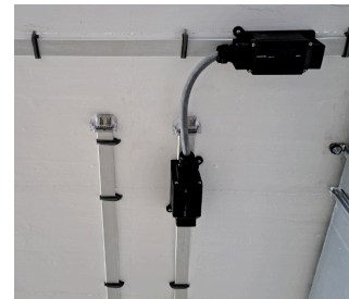
An der Decke installiert
